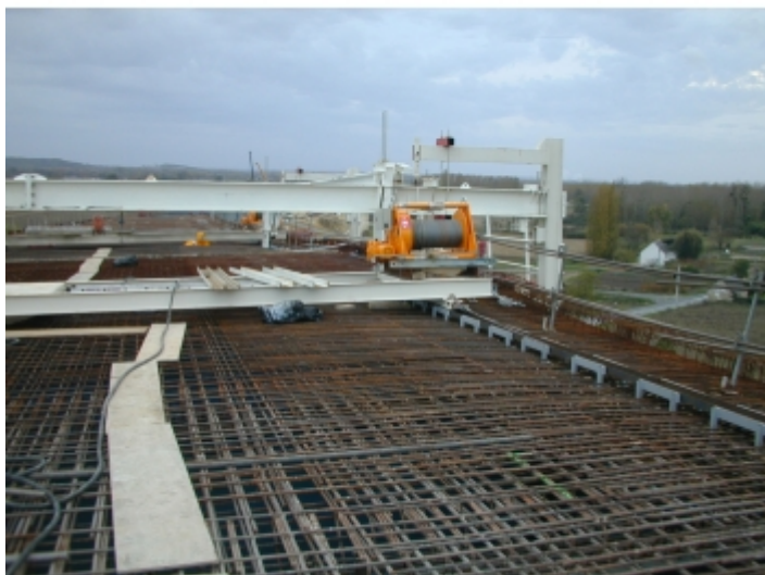
Installation sur un ouvrage d'art
