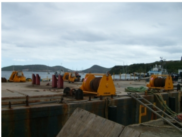
Installation dans un port maritime
