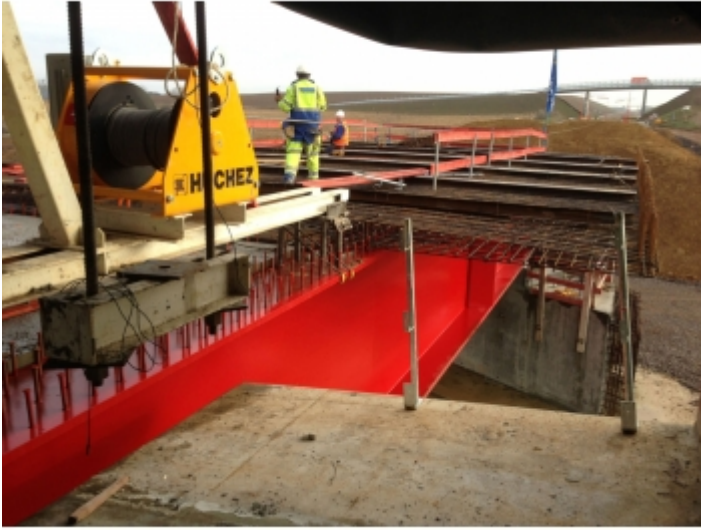
Installations sur un ouvrage d'art
