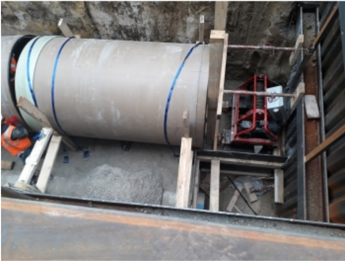
Installation dans un tunnel
