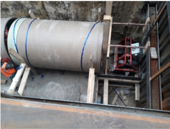
Installation dans un tunnel
