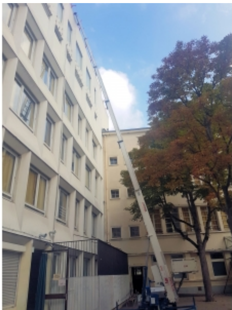
Installation en extérieur : caisse fermée
