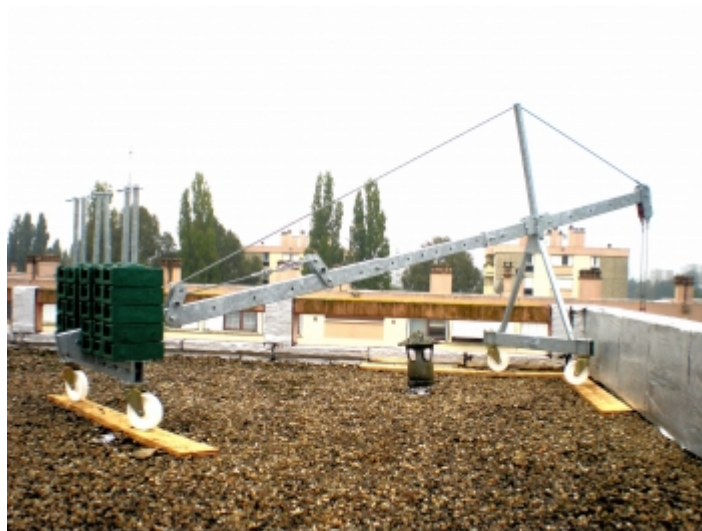
Installation sur une terrasse
