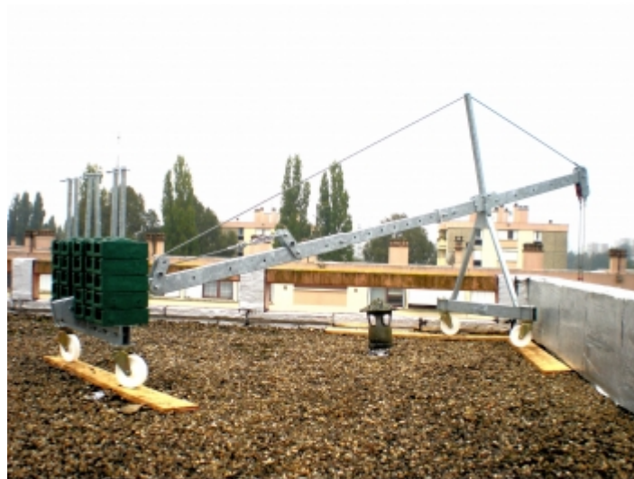
Installation sur une terrasse
