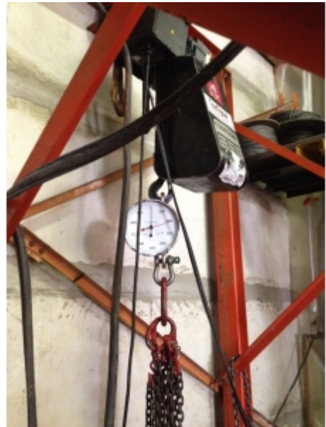
Réglage d'un limiteur de charge sur un palan électrique à chaîne
