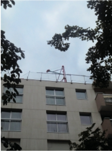
Installation en terrasse
