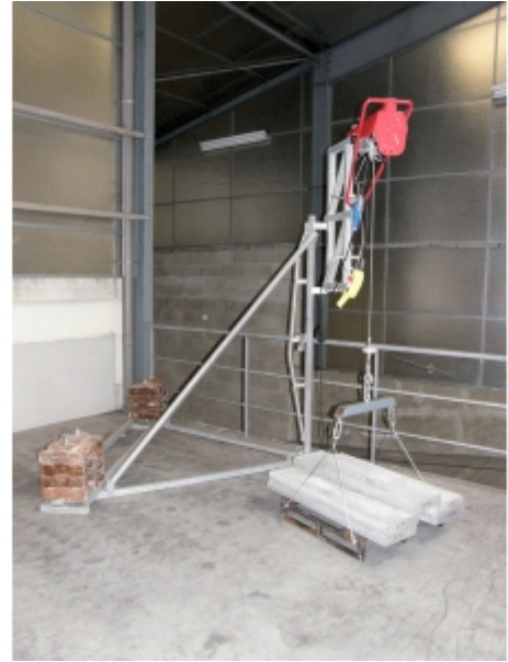
Levage de charges
