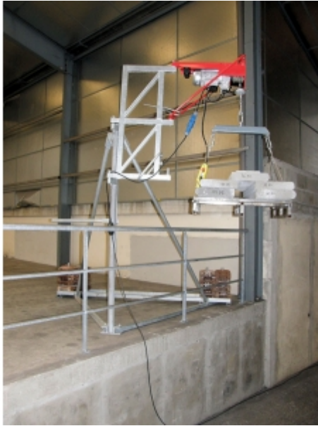
Levage de charges
