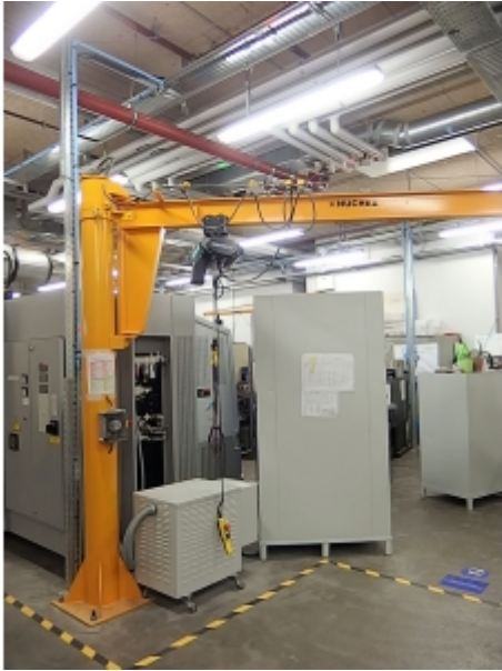
Installation sur portique avec un palan électrique
