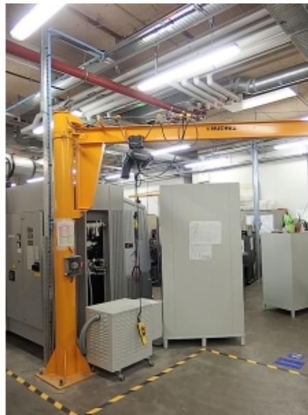
Installation sur portique avec un palan électrique
