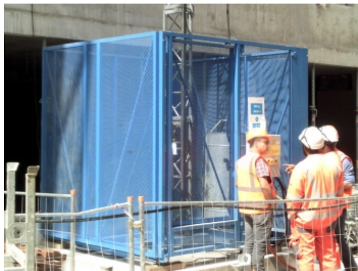
Encagement bas sécurisé
